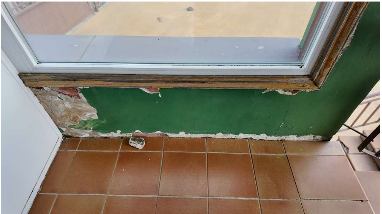
Ausencia de rodapiés
