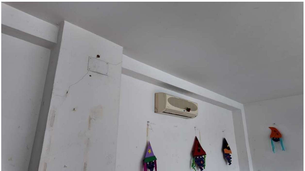
Equipos interiores de calefacción
