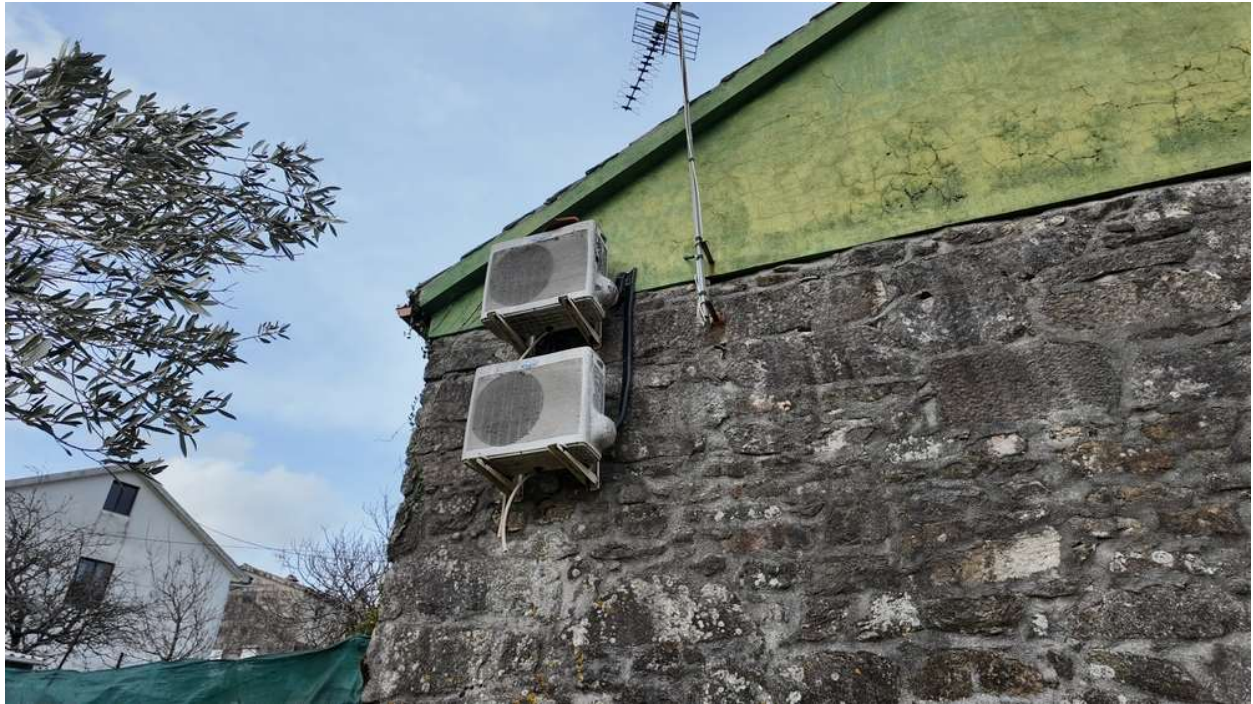
Equipos exteriores de calefacción
